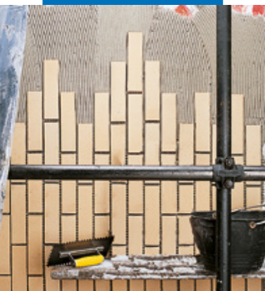
Posa a parete in esterno
